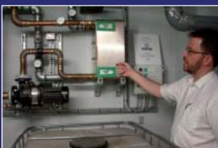
Rørtræk til frikøling
