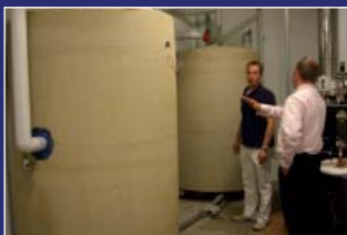
Varmegevinding til brugsvand - 2.500 liter pr. tank.
